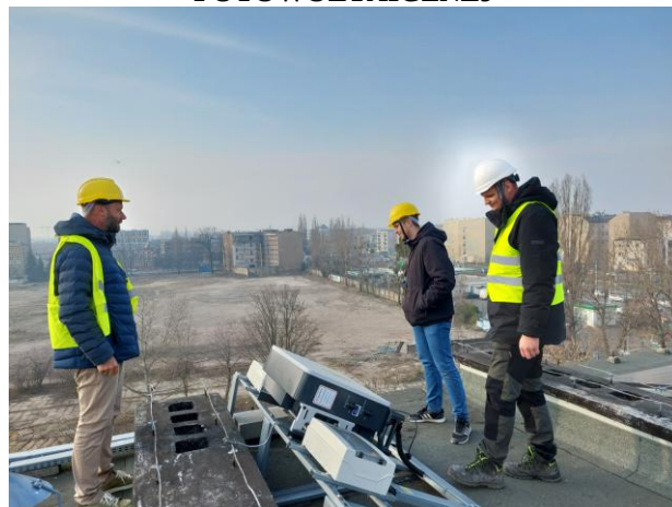
Krótki instruktarz obsługi inwertera czyli falownika na dachu budynku Rolna 16-28
